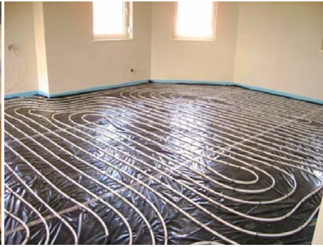
Fußbodenheizung im Mannschaftsgebäude
